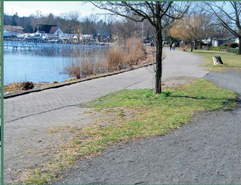
Schäden an den Grünflächen
