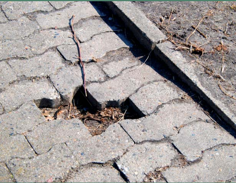
Bauschäden an den Wegen
